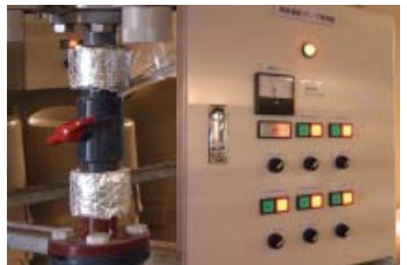
源泉流入量制御システム
